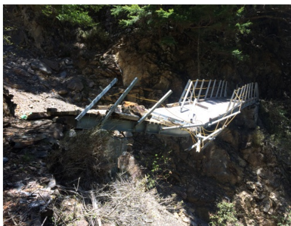
圖 6、棧橋毀損，請沿著山壁小心通過
