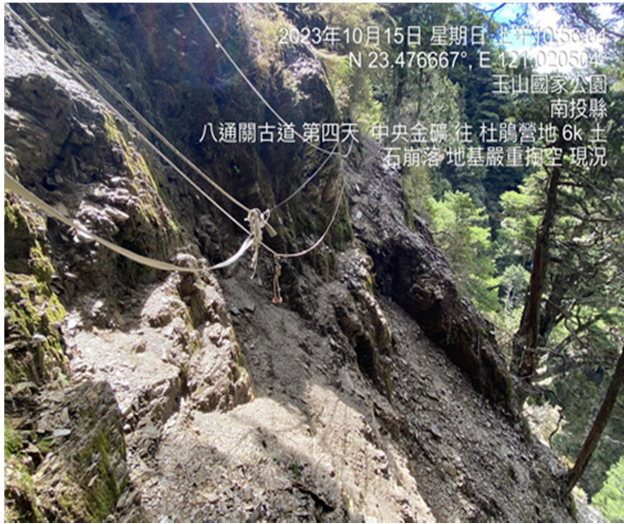
圖 7、中央金礦至大水窟 6k 處嚴重土石崩塌 地基掏空、踏點易碎鬆動
