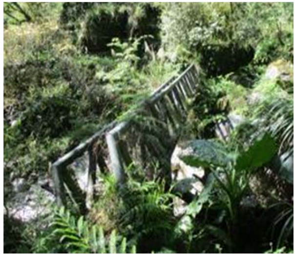
圖 2、棧橋傾斜毀損、橋基不穩，請注意
