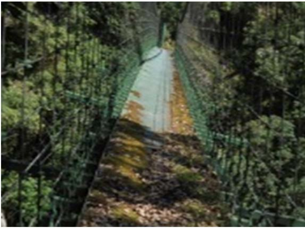
圖 7、吊橋傾斜，請小心通行
