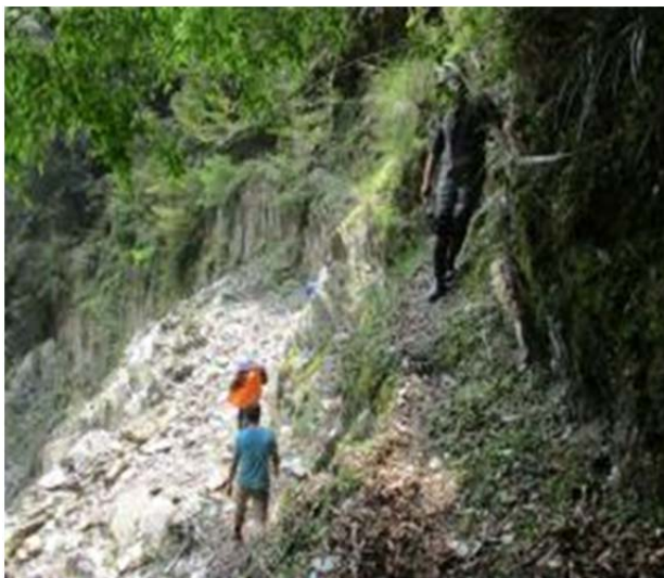
圖 11、路基坍塌、斷崖，請靠內側小心通行
