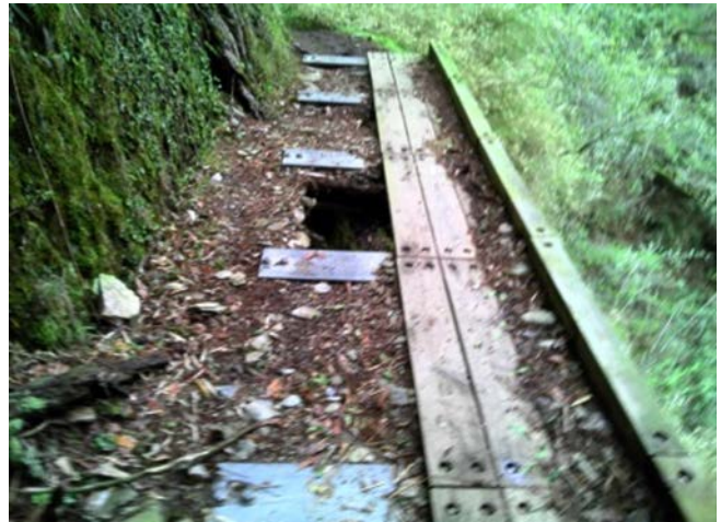
圖 4、步道路基沖蝕缺口，請小心通行
