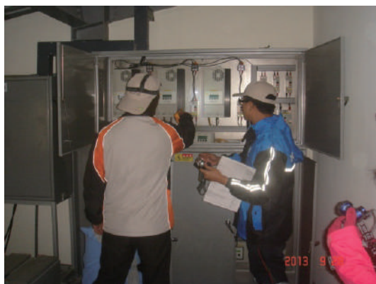
工研院排雲供電案現勘
