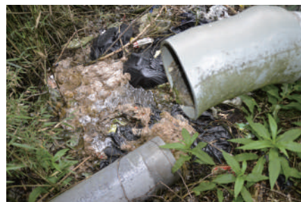
排雲山莊化糞管破損移位
