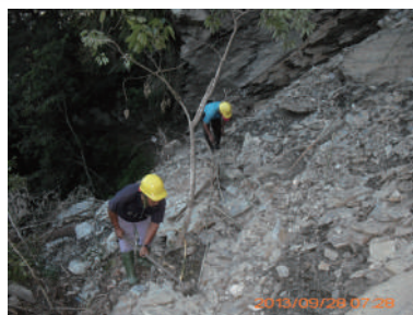
步道坍方整修
