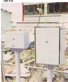
照片 57 國家公園景觀道路入口設置車量偵測器預估車輛數量及遊客數以為經營管理之參考
