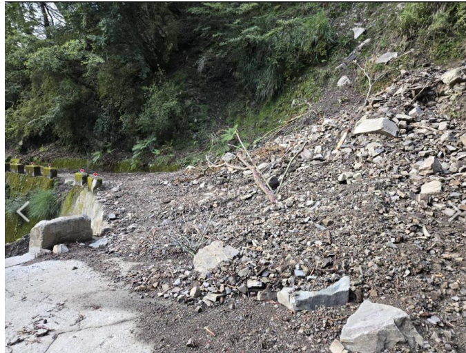
圖 4-1. 楠溪林道 3.0K 處大量土石崩落，車輛難以通行
