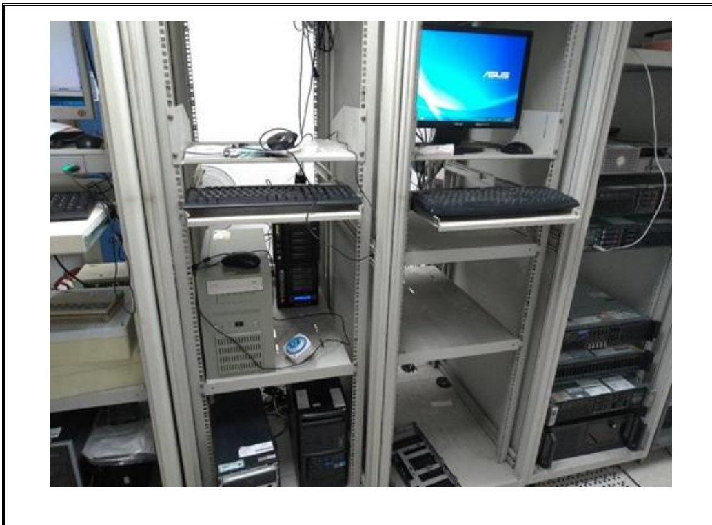
圖 25：中心站機櫃前
