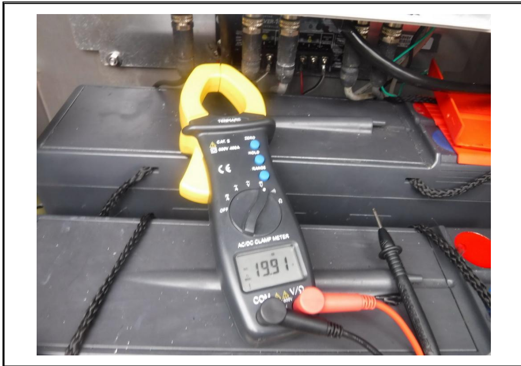
圖 3：塔塔加站太陽能板電壓量測
