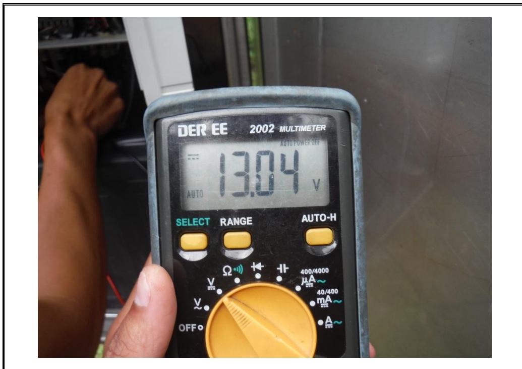
圖 15：南安站電池電壓量測
