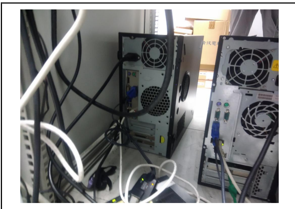
圖 26：中心站機櫃後
