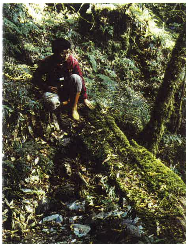
那那托克附近的一座殘存木橋，石砌橋墩仍清晰，但三片橋板中有二片已被沖至下游
