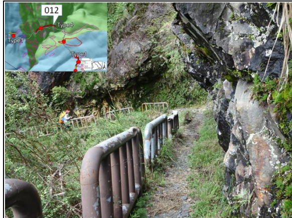
(A) 012N：柵欄凹陷顯示落石頻繁。
