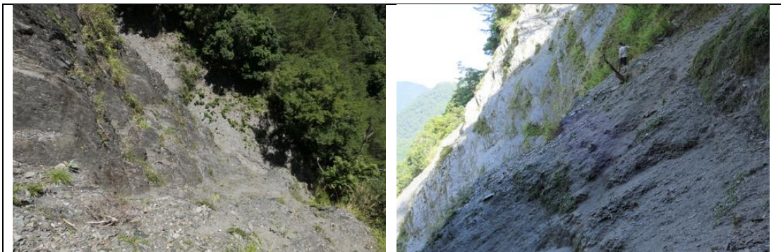
南側大崩塌調查照片，左為崩塌南側，右為崩塌北側，岩壁垂直陡峭無法通行，阻斷的直線距離約為 55 公尺
