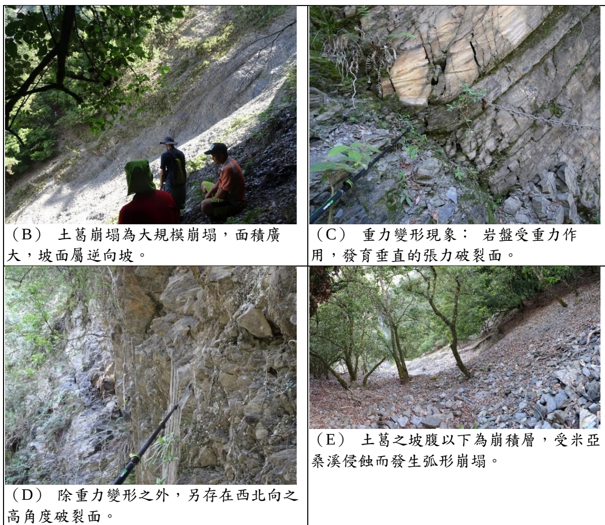
圖 3-3-2 土葛崩塌野外調查照片
