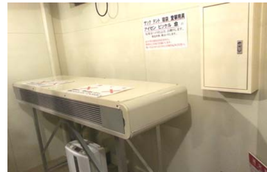
乾燥室的烘乾機及除濕機
