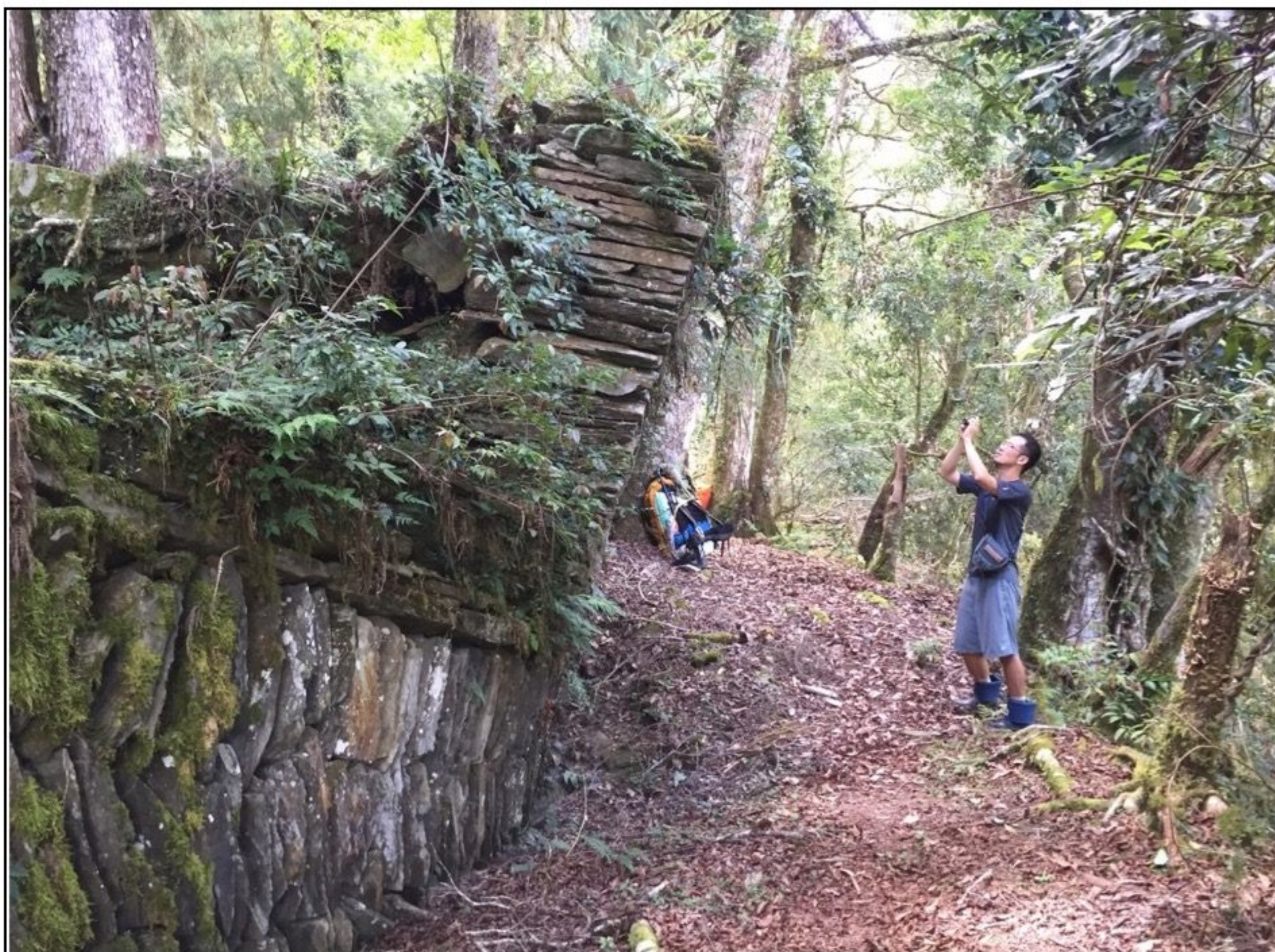
【照片 2-07】2017 年多美麗駐在所下陷傾斜的砌石駁坎。
