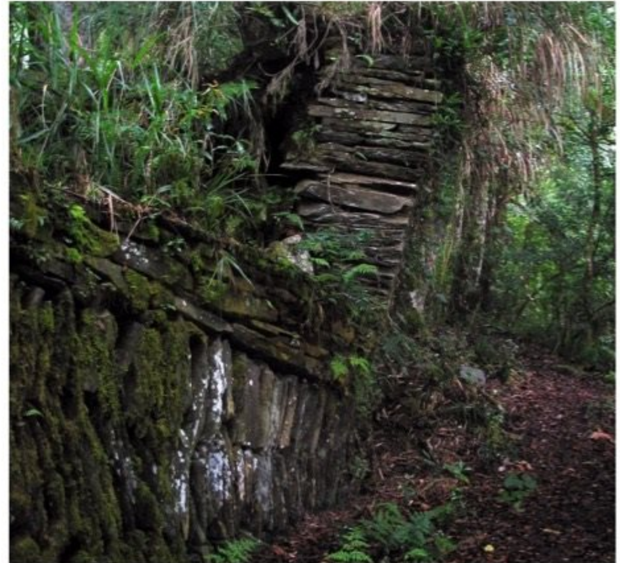
【照片 2-04】2001 年多美麗駐在所下陷傾斜的駁坎。
