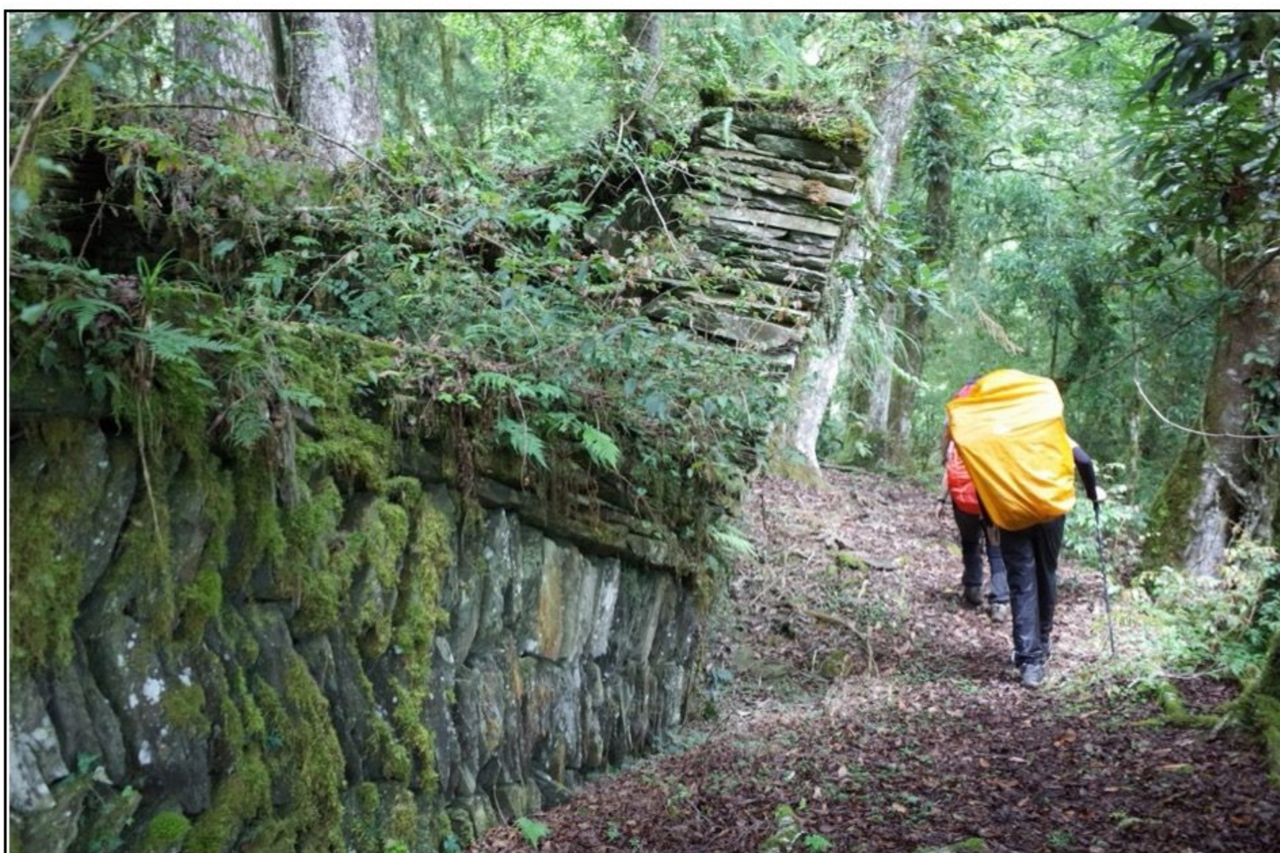
【照片 2-08】2019 年多美麗駐在所下陷傾斜的砌石駁坎。
