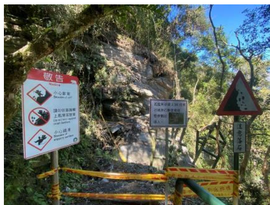
步道 3.1K 棧橋損壞公告
