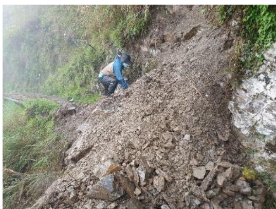
主任吳萬昌及助理保育巡查員何聖恩於 5 月 14 日接獲步道崩塌後，立即前往現場進行排除恢復，確保下山山友之行走安全。
