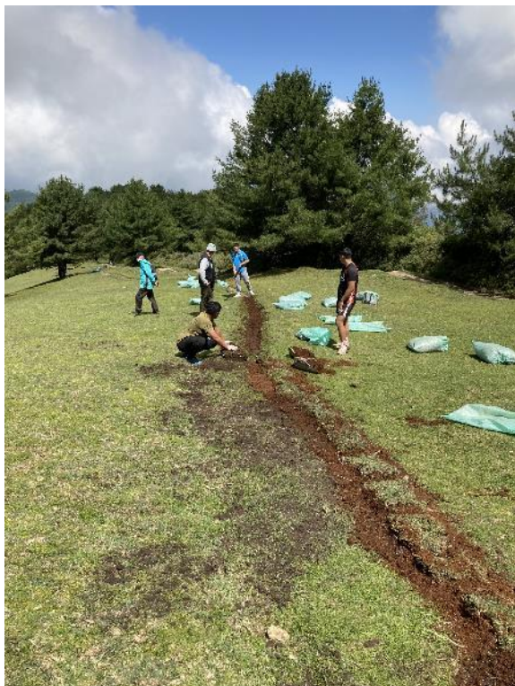
人工開挖步道旁截流溝
