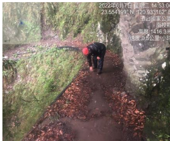
111 年 6 月 7 日步道積水挖洩水坡讓水流出
