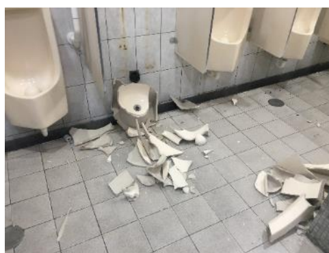
地震損壞照片
