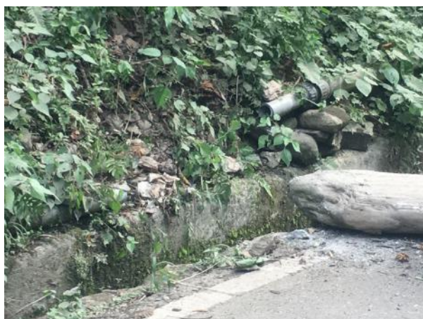
地震造成管脫落
